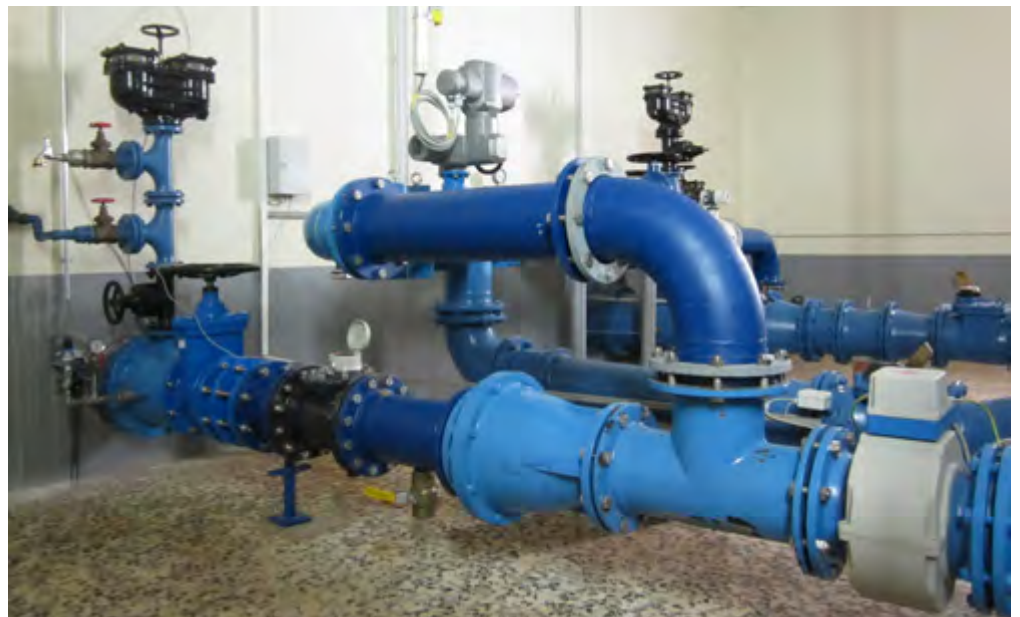
Ein elektrisch betriebenes Ringkolbenventil in der Füllleitung und eine automatische Steuerung sorgen dafür, dass der in der 66 km langen Kinzig-Leitung anstehende hydrostatische Druck zwei Hochbehälter im Frankfurter Stadtgebiet speisen kann.
