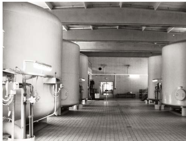
Ein Blick in die Filterhalle
