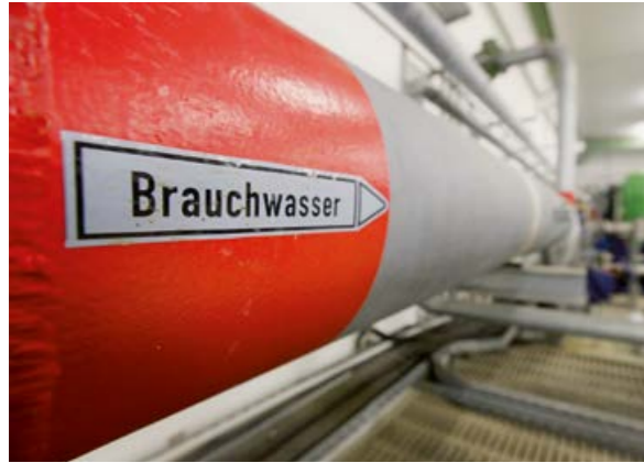
Über ein Fünftel des Wasserverbrauchs wird mit Brauchwasser gedeckt. Es dient der Toilettenspülung und sorgt für Sicherheit – im Netz der Sprinkleranlagen und als Brandreserve für die Feuerwehr.
