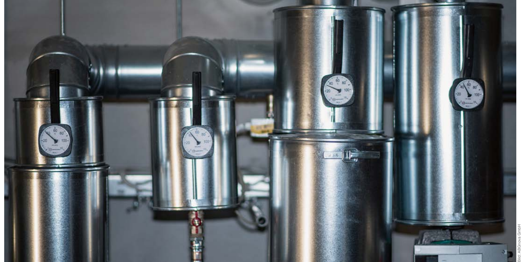
Messeinheit zur Temperaturmessung des Wassers und Abwassers bei der Wärmerückgewinnung
