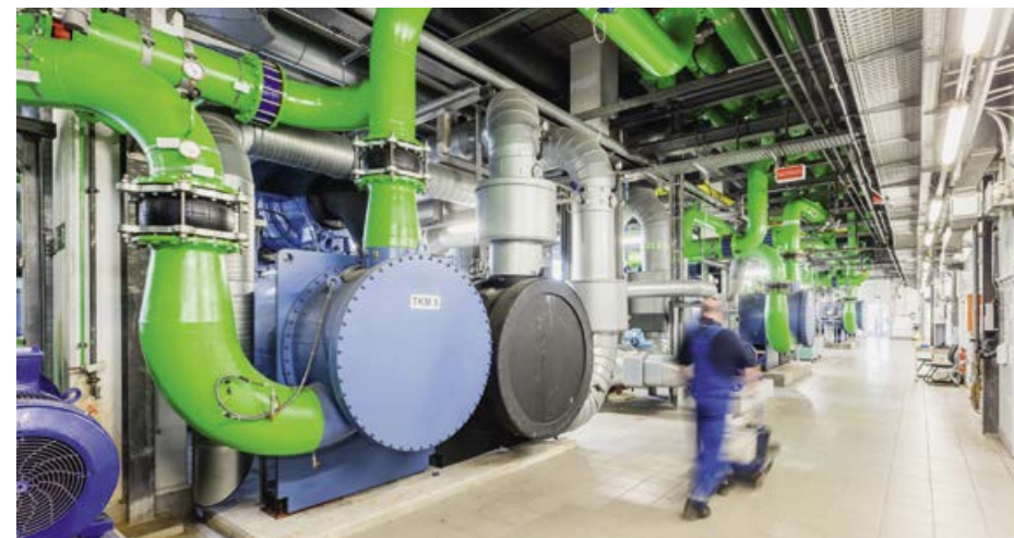
Blick ins Innere des Heiz-Kältewerks der Mainova für den Frankfurter Flughafen
