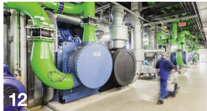
Die Nutzung von aufbereitetem Oberflächenwasser als Betriebswasser schont die Grundwasserressourcen.
