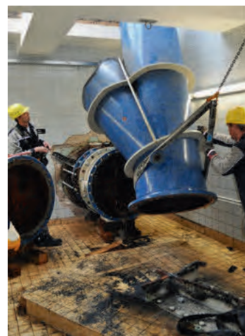
Alle Hände voll zu tun haben die Arbeiter beim Umbau der beiden Transportleitungen im Messschacht.
