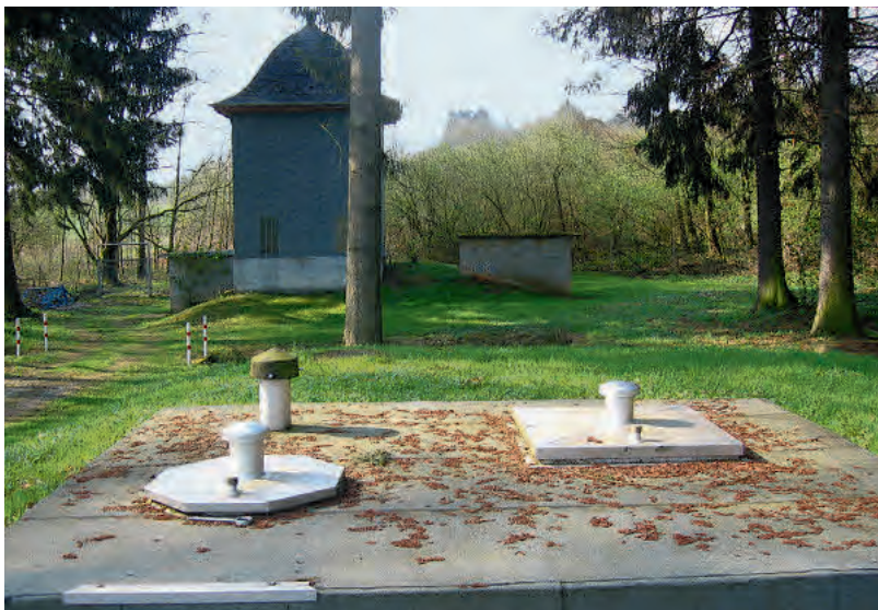
Brunnenanlage des Wasserwerks Harb in Nieder-Rosbach.
